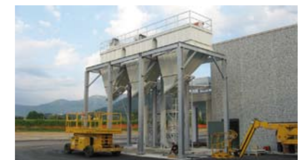
Pneumatische Anlagen für den Spanabtransport
